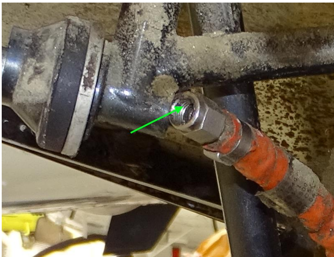
Foto 9: dettaglio del connettore della tubazione del sensore della pressione dell'olio con presenza di terriccio all'interno.
