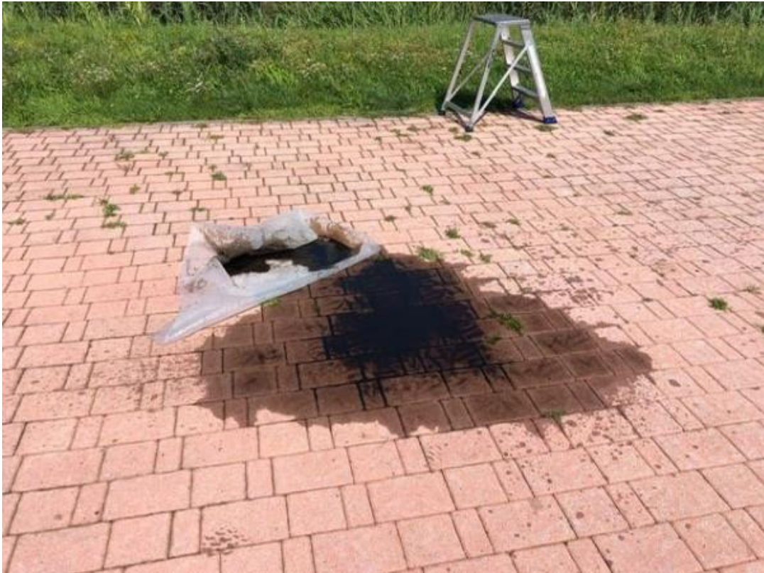
Foto 5: pozza di olio in corrispondenza del punto di messa in moto (piazzola rifornimento).
