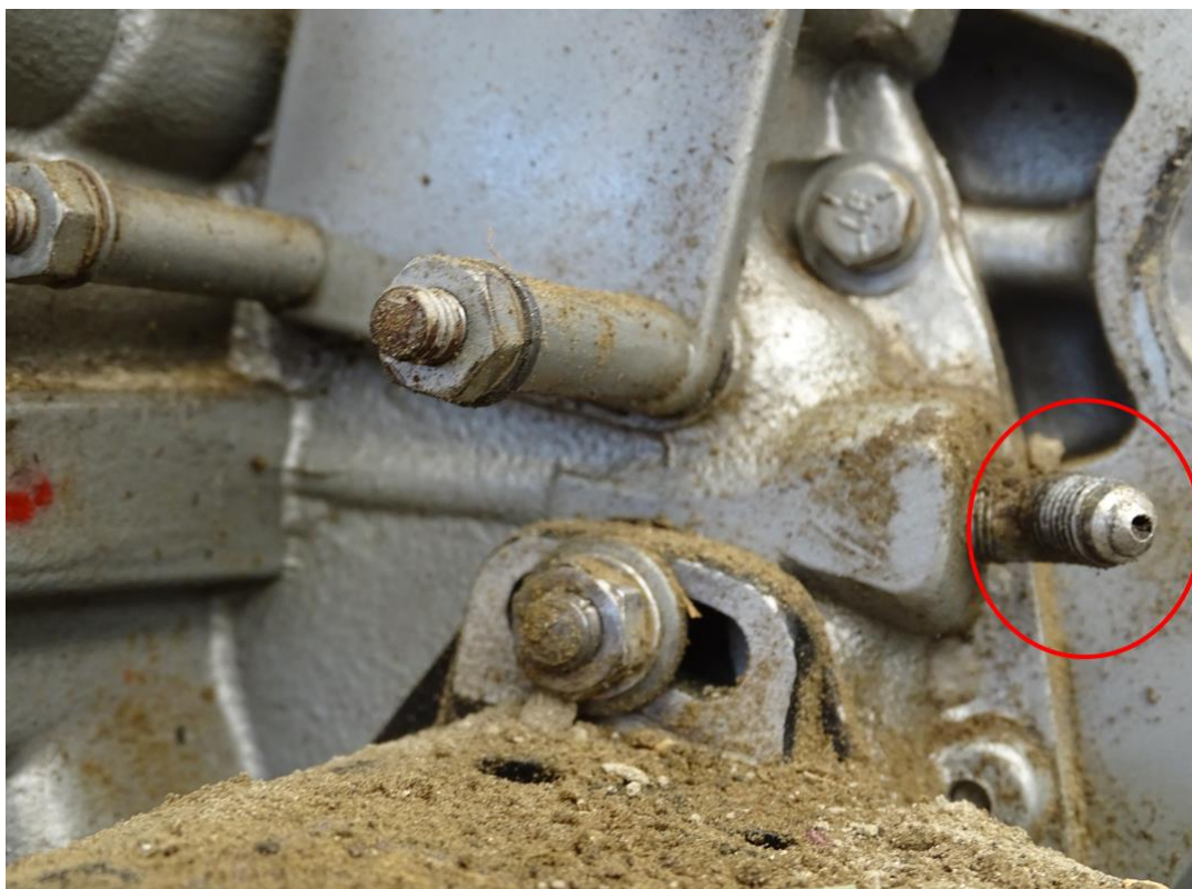
Foto 8: dettaglio del punto di attacco della tubazione del sensore della pressione dell'olio con presenza di terriccio nell'ugello.
